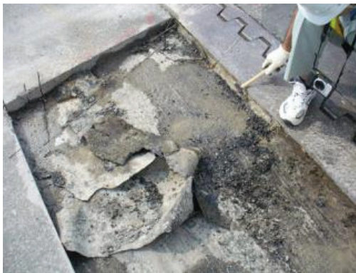
写真-1 防水層の損傷例
