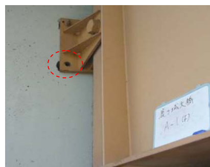
図-6 落橋防止装置のアンカーボルトの欠落（鹿ヶ城大橋）
