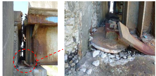
図-9 桁の脱落および支承の損傷 (志田橋)
