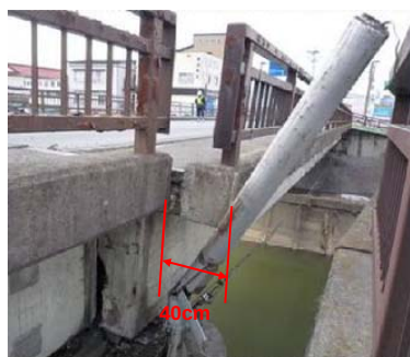
図-4 P2 橋脚における桁の水平移動（錦橋）
