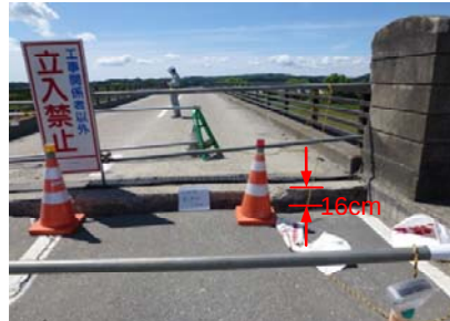
図-11 橋台背面土の沈下 (志田橋)
