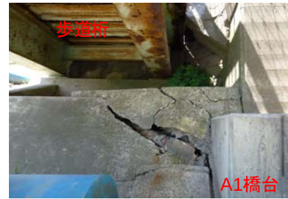
図-12 護岸沈下による損傷 (敷玉橋)
