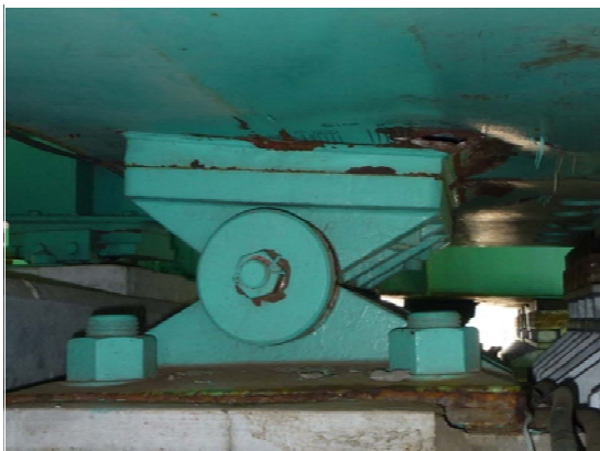
図-8 支承受け部の損傷状況（G2，側面）
