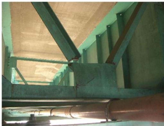
図-3 P5 橋脚支点上での対傾構の破断
