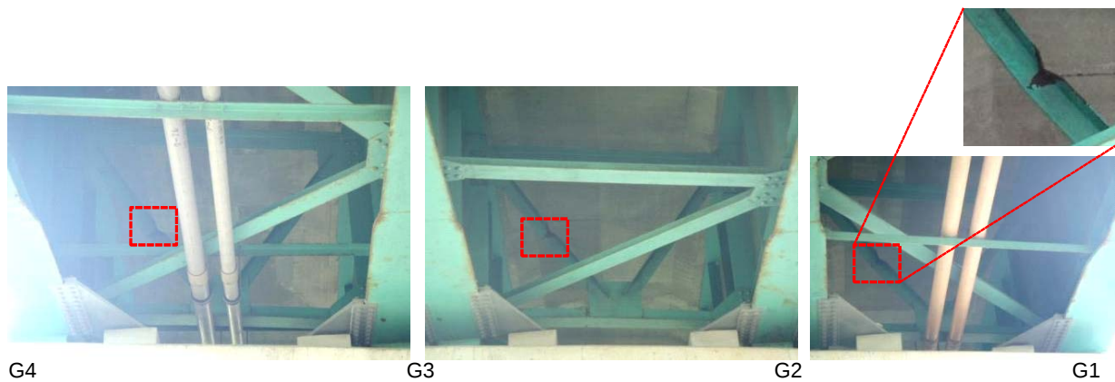
図-2 P3 橋脚支点上での対傾構の損傷
