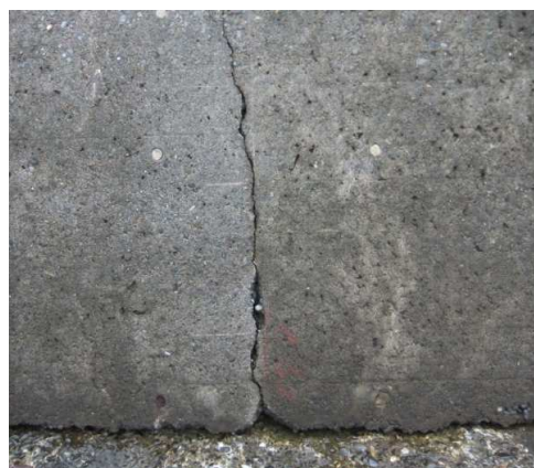
図-1 胸壁に発生したひび割れの例
