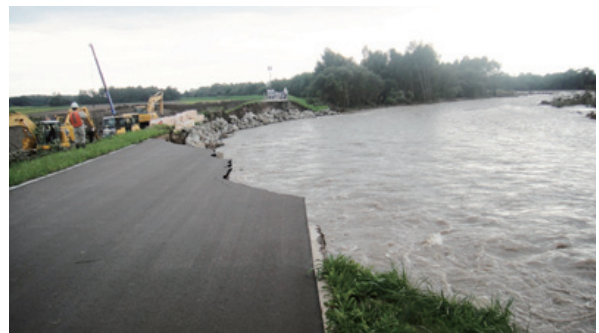
図-2 応急対策直後の現地状況 (平成23年9月9日 15:30)
