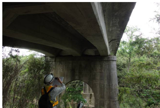
写真-1 被害が極小さい年代の古い無補強の橋梁 (宮城県築館; 震度 7)
