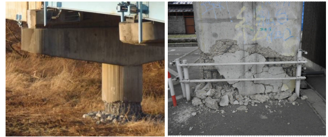
写真-2 東北地方太平洋沖地震による宮城県内の橋脚被害（左；段落し部の被害，右；基部の被害）
