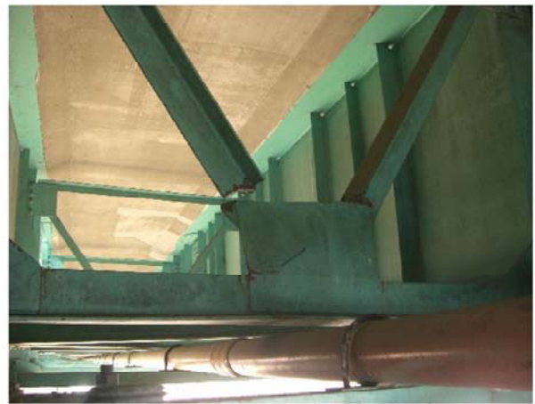
図-3 終点側連の中間支点上対傾構の損傷
