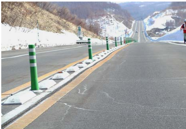
写真-1 切土部の路面凍上状況
