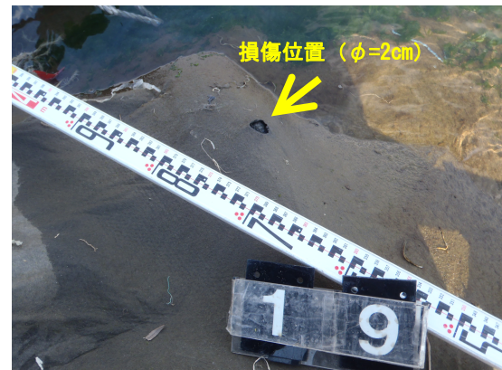
写真-1 断面 1 シート損傷状況
