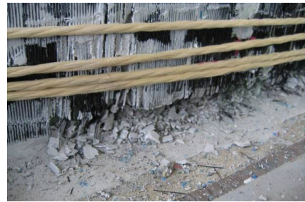
図-7 CFRP シートの破断
