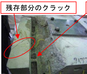
写真 3.5 支承破砕状況 2
