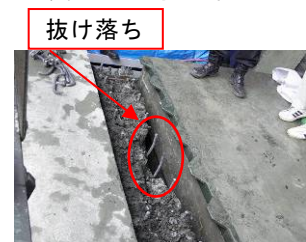
写真 3.7 伸縮装置破砕状況 2
