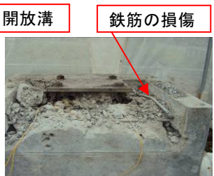
写真 3.6 支承破砕状況 3
