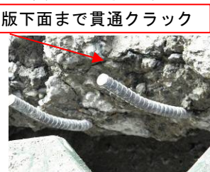
写真 3.6 伸縮装置破砕状況 1
