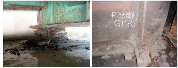
写真-4 桁端部および支承周り損傷事例
