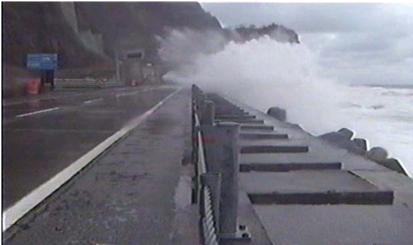
写真-1 現地における越波の状況
