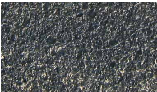
写真1 水路コンクリートの表面劣化
