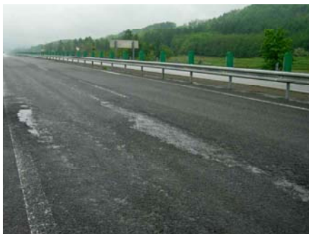
写真-1 高機能舗装の損傷状況
