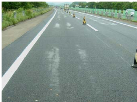
写真-4 ハイブリッド舗装のフラッシュ発生状況
