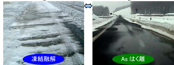
写真-2 高機能舗装の損傷状況
