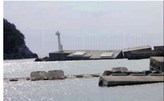
Fig.1 周参見漁港防波堤崩壊 (和歌山)
