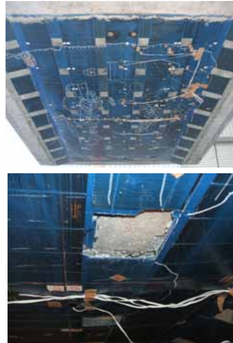
写真 - 2 破壊状況
