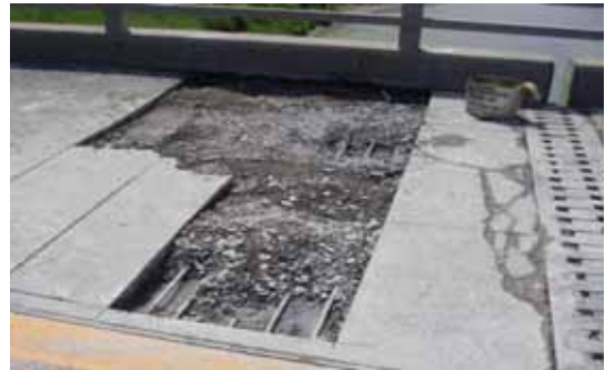
写真-1 凍害損傷（砂利化）状況
