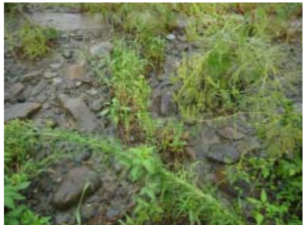
写真-5 孔部の土砂に根付く植物
