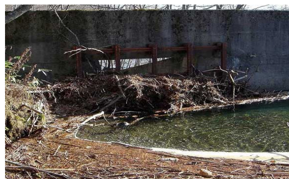
写真-2 魚道直上流部流木堆積状況
