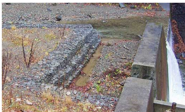
写真-1 魚道直上流部砂礫堆積状況
