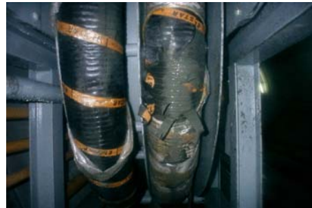
写真-6 エルスターホース破損状況
