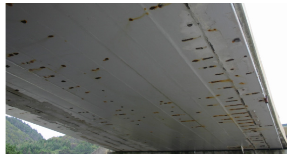
写真-3 塩害損傷度2の一例（飛沫帯橋梁）
