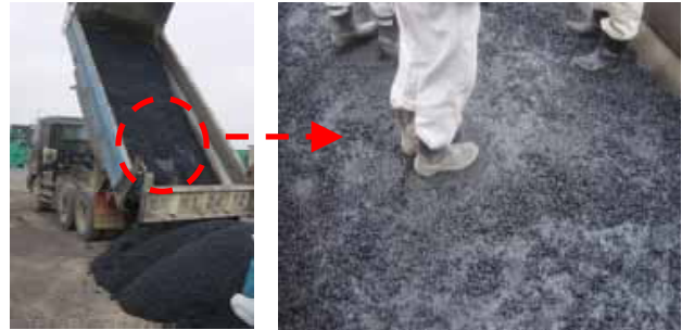
写真1 ダンプ荷台におけるダレの発生状況
