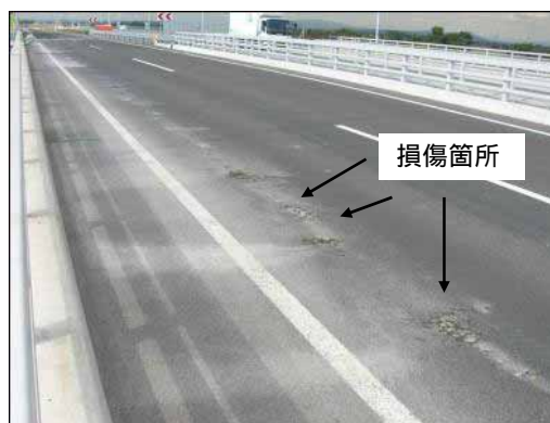
写真-1 橋面損傷状況
