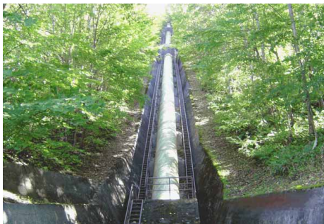
写真－9 水圧鉄管全景
