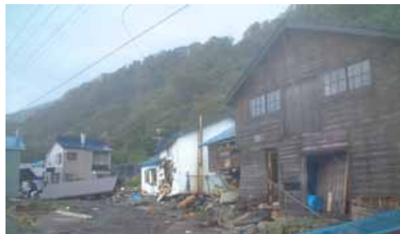
写真-1 越波による家屋の半壊状況
