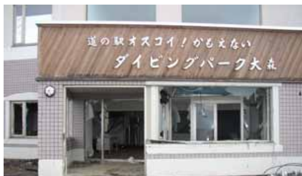
写真-2 道の駅「オスコイ!かもえない」の被害状況
