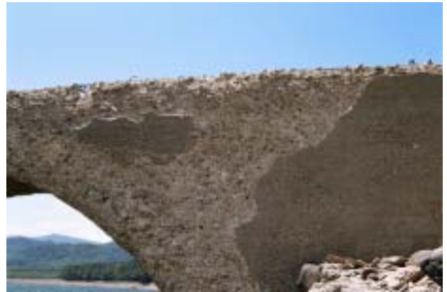
写真 2.5 タウシュベツ川橋梁の表面劣化状況
