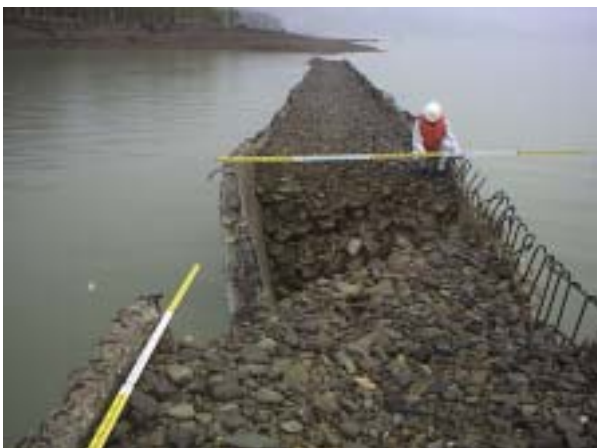
写真 2.4 タウシュベツ川橋梁の地震による損傷状況(十勝三股側 6 スパン目付近,湖岸側アーチ側壁、アーチ上部よりと 6p 目地付近より崩落、例年より大雪のため水位高い、撮影:2004 年 5 月 24 日)
