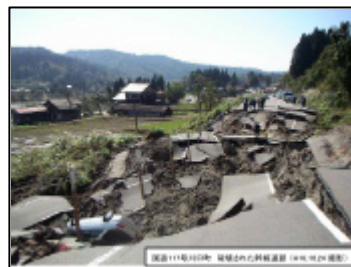
写真1 国道117号(川口町) 破壊された幹線道路
