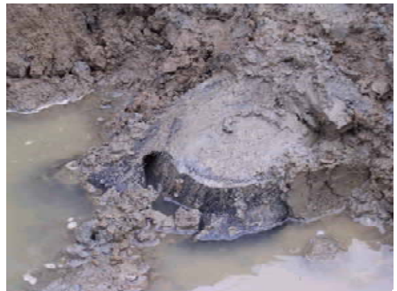
写真-4 土木シートから突出した木杭頭部
