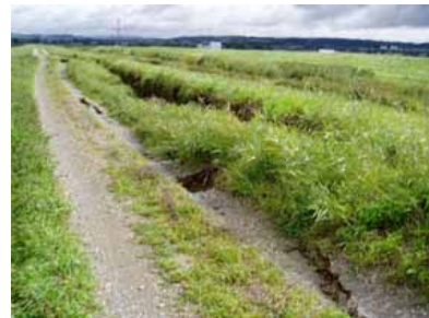
写真－1 右岸側の被災状況
