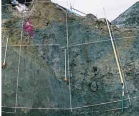
写真-2 クラック群と液状化して噴き上げた砂
