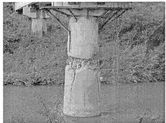
写真-1 橋脚損傷全景
