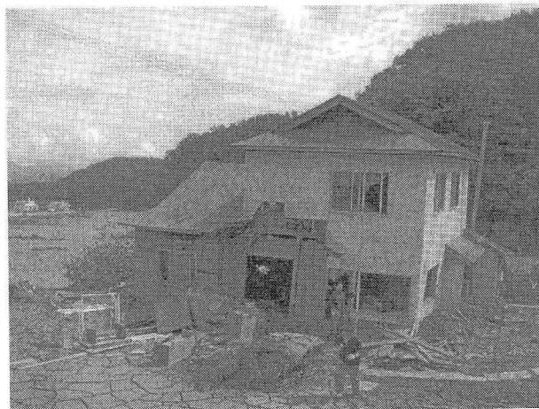
写真4 崩壊した民家(地点D)
