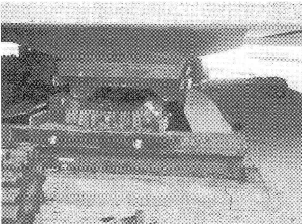
写真-1 2 十勝河口橋の支承の破壊状況 (3)
