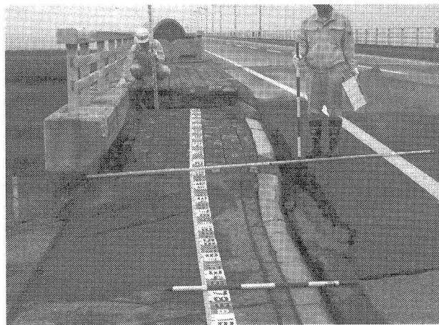
写真-1 3 十勝河口橋の橋台背面盛土の沈下
