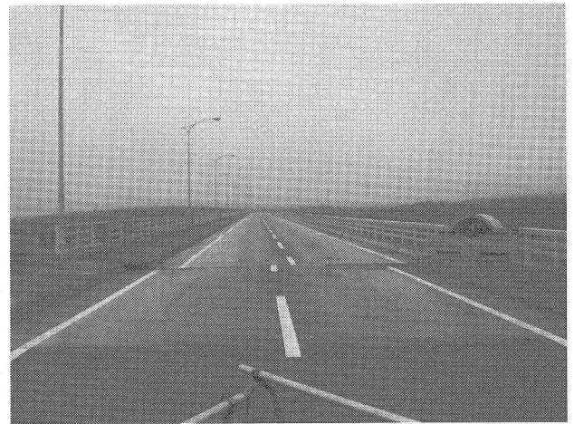
写真-9 十勝河口橋の横ずれ
