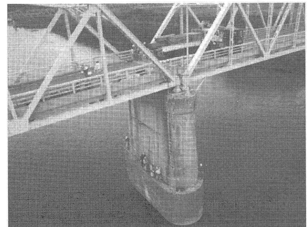
写真5 千代田大橋の橋脚天端の損傷（1）
