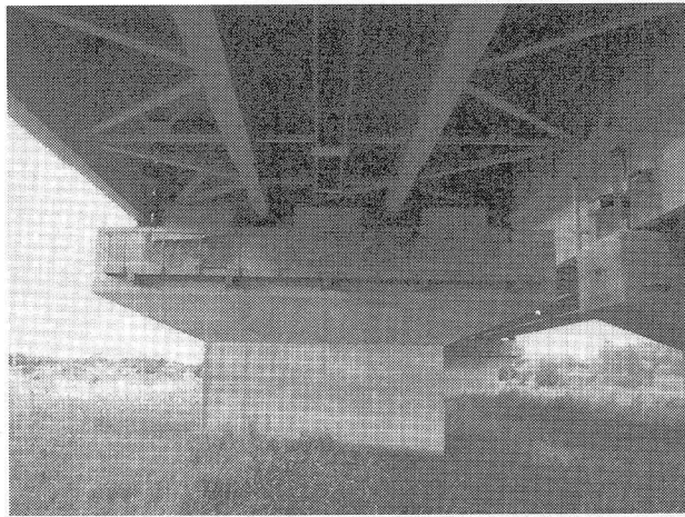
写真-3 静川高架橋の変位制限装置の損傷
