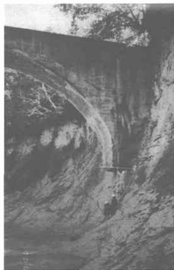
写真 3.1.2 第六音更川橋梁橋台の洗掘状況
