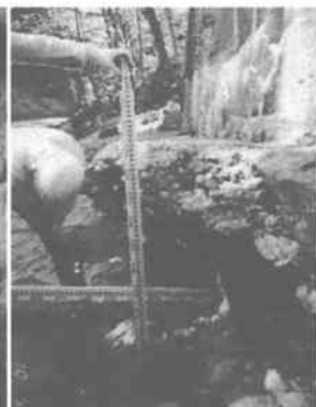
写真 3.1.3 橋脚の洗掘状況（第六音更川橋梁 P1）
