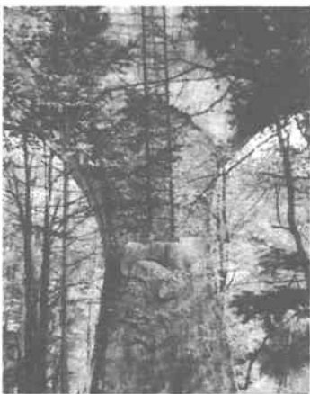
写真 3.1.6 橋脚の表面剥離状況
