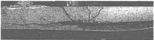
Fig.2-1 CFS 補強 RC 梁の破壊（かぶり 35mm）
