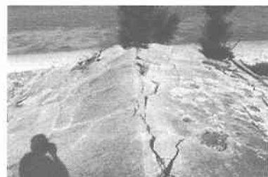
写真4 石垣島旧沖縄台湾間通信施設の 屋根（RC）の劣化状況と被弾痕
