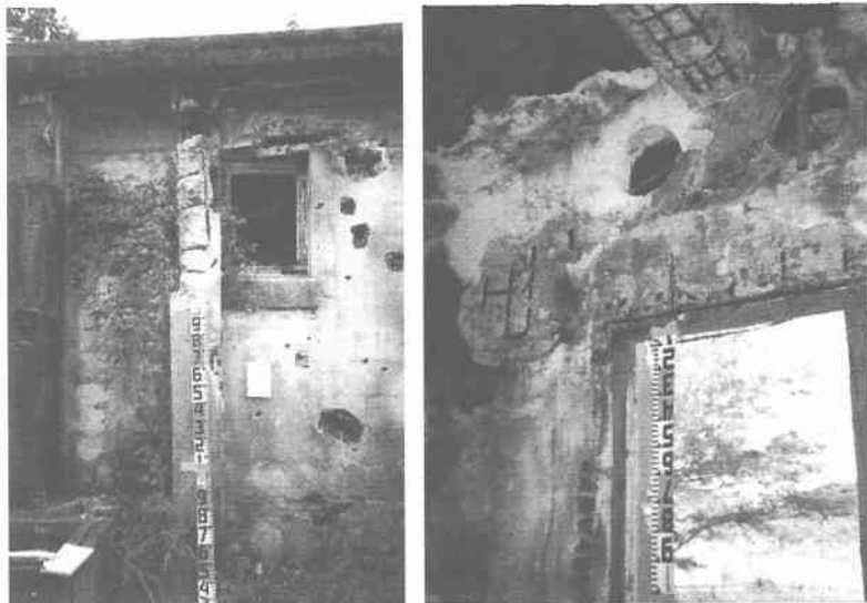
写真 5,6 石垣島旧沖縄台湾間通信施設の RC 柱及び被弾痕と施設内部の梁の腐食状況
