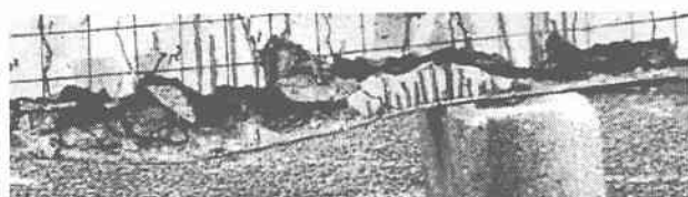
図-3 端部からのコンクリートの付着破壊
