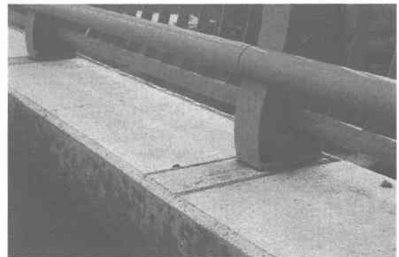
写真-7 地覆上面状況
