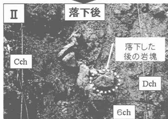
図-6 自然に発生した落石前後の落下始点と終点の状況
