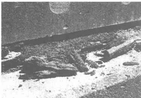
図1 CA モルタル劣化状況
