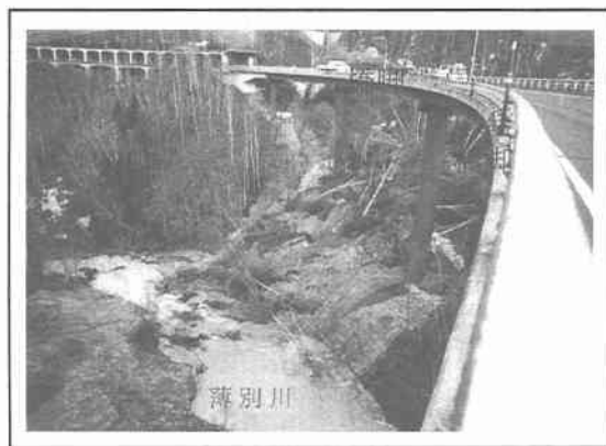
写真-4 崩壊土砂到達状況（崩壊直後）
