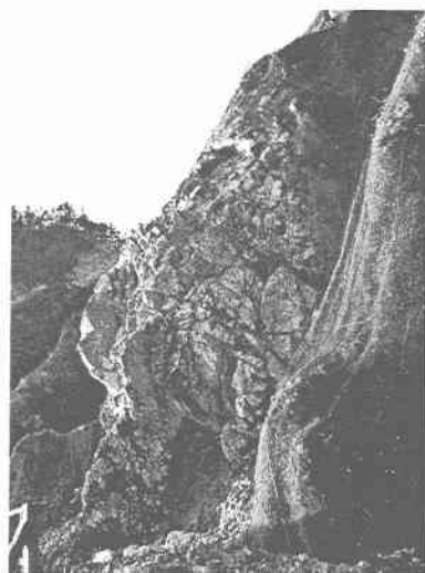
図2 広尾町側斜面の亀裂状況
