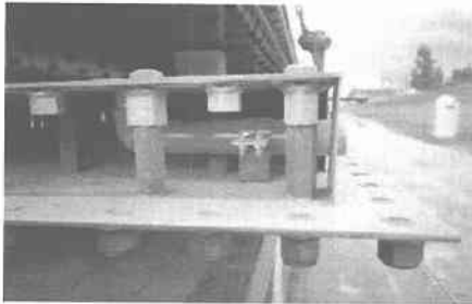
写真-3 排水パイプ
