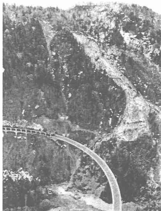
図一 地すべり状況
