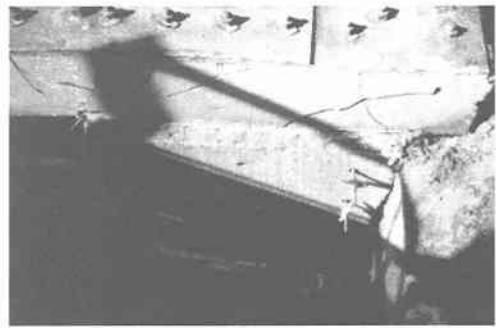
写真-3 頂板と壁の接合部の状況（供試体2）
