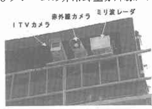
写真-3 設置状況
