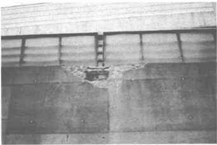
写真－３ 高欄支柱部の損傷
