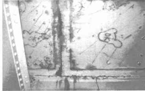
写真－1 損傷状況の一例
