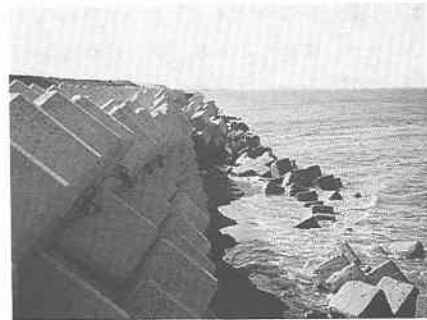
写真-1 捨石が洗掘され、前列のブロックが崩落している。
