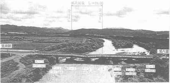
写真-1 被災全景(下流側から)
