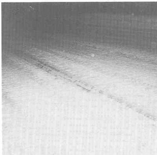
写真-1 ケース1 散布前路面状況
