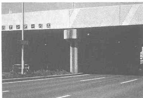
写真一一 橋脚の汚れ
