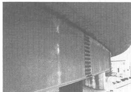
写真－5 耐候性鋼板の錆
